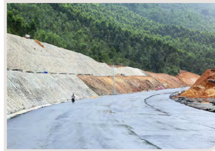
▲ Đường dẫn phía Bắc hầm Cù Mông chờ trải thảm lớp cuối
