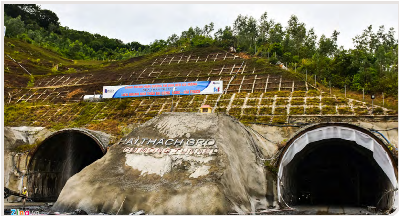
▲ Dự án hầm đường bộ xuyên đèo Cù Mông dài hơn 6,6km, trong đó phần hầm dài gần 3km với tổng vốn đầu tư gần 4.000 tỷ đồng, được đầu tư theo hình thức BOT (Xây dựng - Khai thác - Chuyển giao) và BT.
