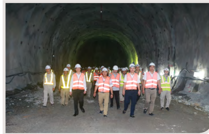
▲ Chủ tịch HĐQT Hồ Minh Hoàng và Lãnh đạo công ty thăm và kiểm tra trên công trường hầm Cù Mông
